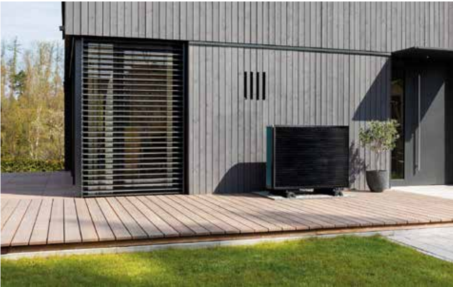
Daikin Altherma-3-R-MT, venkovní jednotka ERRA
