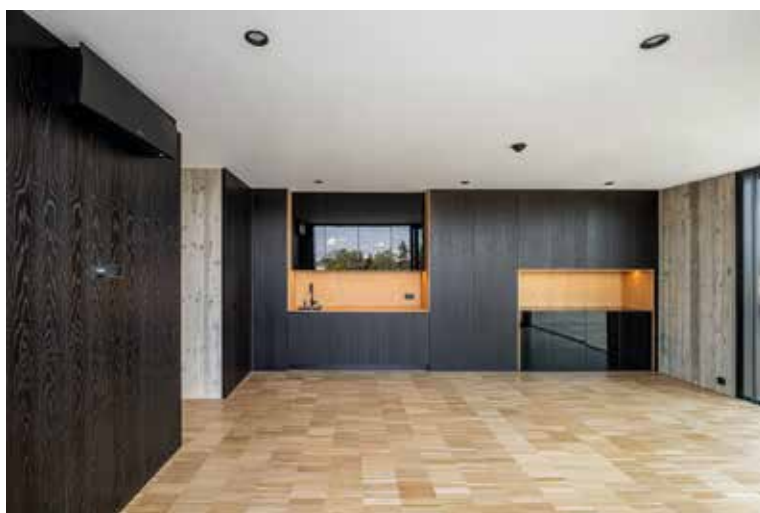
Vlevo na zdi zcela nenápadná vnitřní nástěnná klimatizační jednotka Daikin Emura v černé barvě
