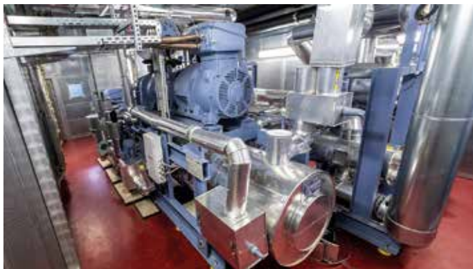
Stroužovna s tepelnými čerpadly GEA v elektrárně na kombinovanou výrobu tepla a elektřiny v německém městě Lemgo (Foto: GEA/Tim Luhmann)
